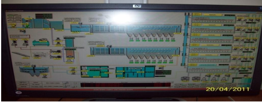
KÜÇÜKLER BARAJI İÇME SUYU ARITMA TESİSİ DURULTUCU ÜNİTESİ
